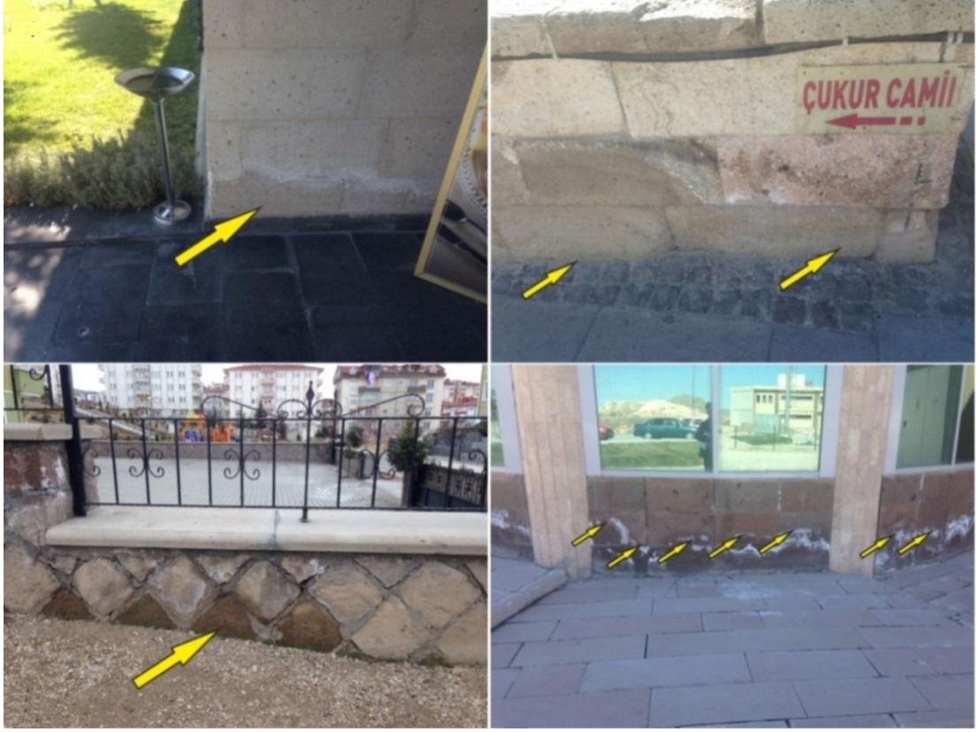
Resim1.3. Bazı güncel yapılarda kullanılan ignimbiritlerde kılcal su emme etkisiyle gelişen bozunma örnekleri
